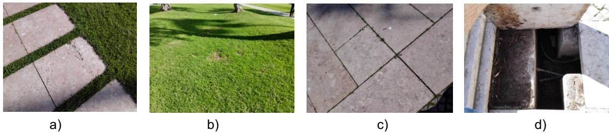
Figura 4.6. Registo fotográfico da cobertura X: a) revestimento de pedra dos caminhos danificado, b) vegetação seca, c) vegetação infestante nos caminhos de acesso, d) sujidade e acumulação de detritos nas caleiras.
